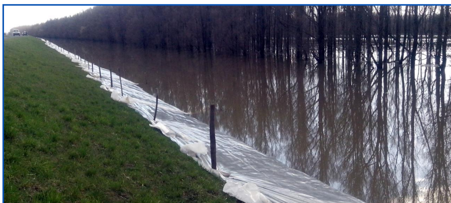
Töltésrepedés fóliás bevédése
