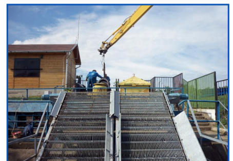
Makkodi szivattyútelep felújított gerebek
