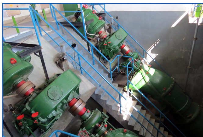
Üzemelnek a szivattyúk
