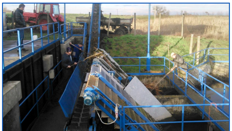
Az uszadék eltávolítása állandó munkát jelentett a szivattyútelepeken
